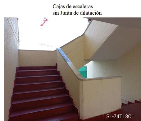
Figura 3: Bloques con cajas de escalera con y sin junta de dilatación.
