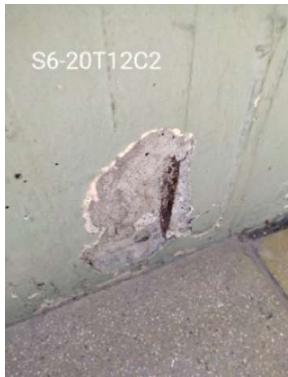
Figura 21. Pérdida de recubrimiento y oxidación de armadura.
